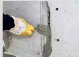
Trhliny a pukliny se pečlivě vyplní maltou (popř. se předtím rozšíří).
